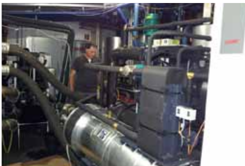
Plansee Reutte, Industrielles Fernheiznetz, Nutzung von Abwärme aus dem Fertigungsprozess OCHSNER Hochtemperatur-Industriewärmepumpe IWHS 400 R3
